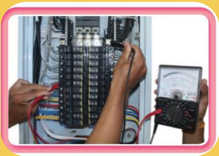
การวัดแรงดันไฟฟ้าลูกลอยของโหลดเซ็นเตอร์แบบเมนเซอร์กิตเบรกเกอร์
