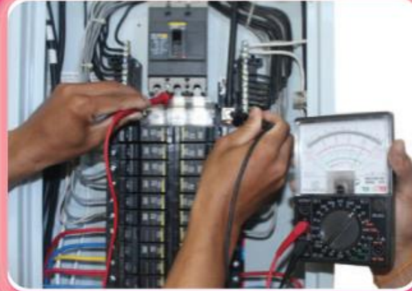
การวัดแรงดันไฟฟ้า ระหว่างเฟส B กับสายนิวทรัล
