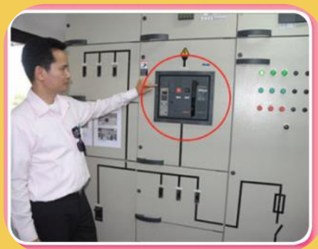
(ข) ตัวอย่างการใช้งานแอร์เซอร์กิตเบรกเกอร์ แบบติดตั้งอยู่กับที่
